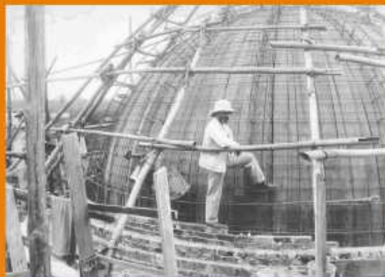
Manovali, cemento armato e tralicci di ferro sono gli elementi essenziali per la costruzione della grande cupola del Palazzo del Trono.
